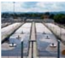
Plantas de Tratamiento de Agua
